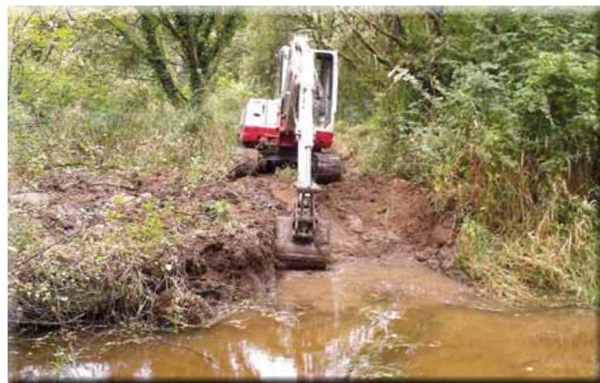
En préalable à l'engagement du CTMA, deux méandres du Roz millet ont été réactivés. Ces deux anciens méandres, encore visibles, ont été réouverts à la pelle mécanique et remis en eau grâce à l'installation de seuils de rives.
